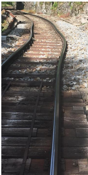
Déformation des voies ferrées
