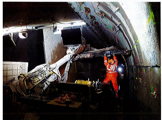
7 Bohrarbeiten für die Anker der Ausbruchsicherung Drilling work for the anchors of the excavation support
