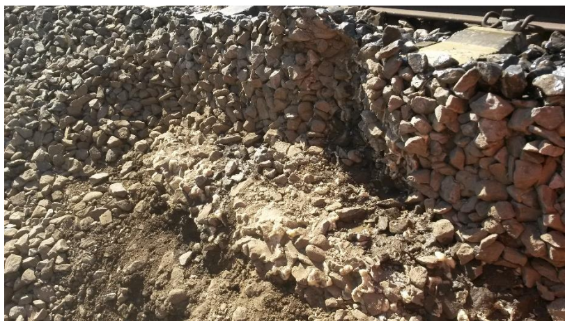
Abb. 3: Zu viel Kleber im Schotter; auf der Planie ist der Kleber seitlich weggeflossen und hat dabei die Poren des Schotterbetts gefüllt (keine Durchlässigkeit mehr)
