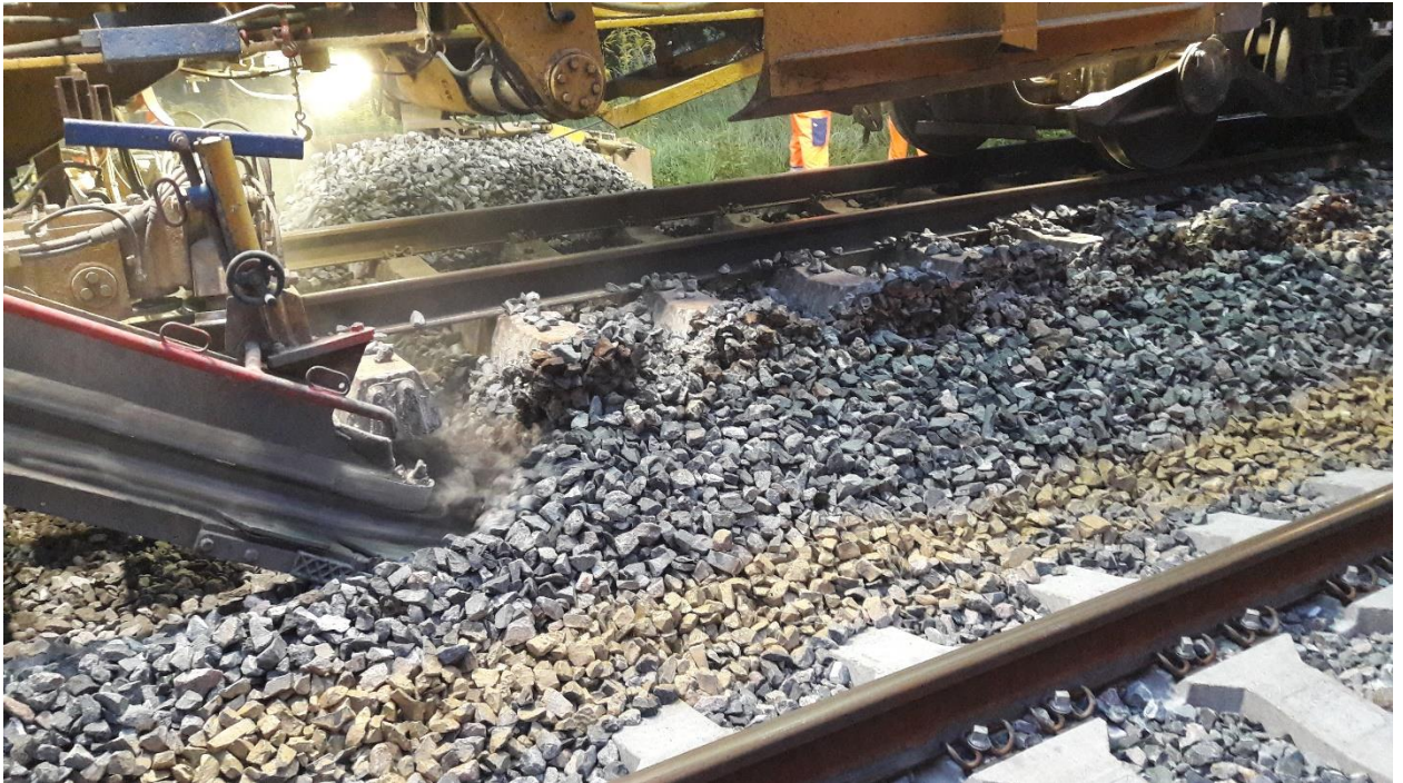
Abb. 4: Rechts oben im Bild: verklebter, mittels Weichenstopfmaschine gestopfter Schotter (Schollen) über Schwellenköpfe; Links oben: Reinigung des Schotters; unten: seitlich der Schwellenköpfe verklebter Schotter (ohne anschließende Stopfung und Reinigung)
